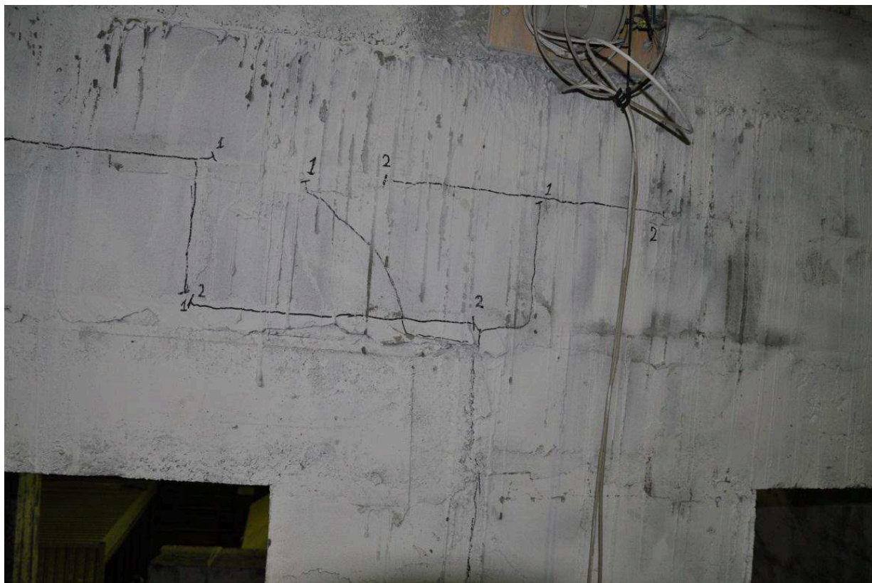
Фото 18. Образование трещин в кладке стены расположенной по оси «А» с наружной стороны
