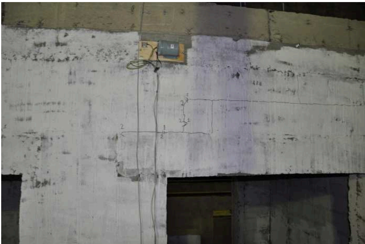
Фото 23. Образование трещин в кладке стены расположенной по оси «Б» с внутренней стороны
