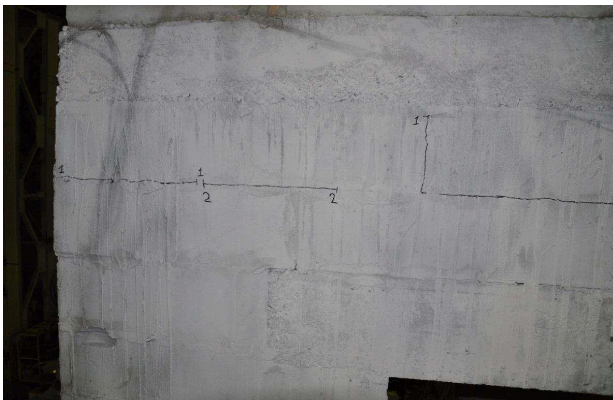
Фото 17. Образование трещин в кладке стены расположенной по оси «А» с наружной стороны
