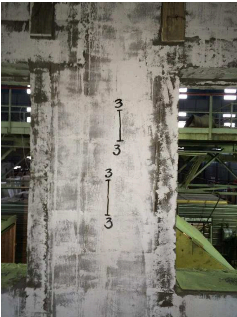
Фото 21. Образование трещин в кладке стены расположенной по оси «Б» с внутренней стороны
