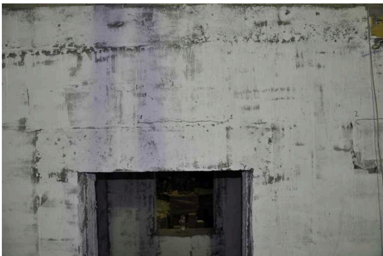
Фото 22. Образование трещин в кладке стены расположенной по оси «Б» с внутренней стороны
